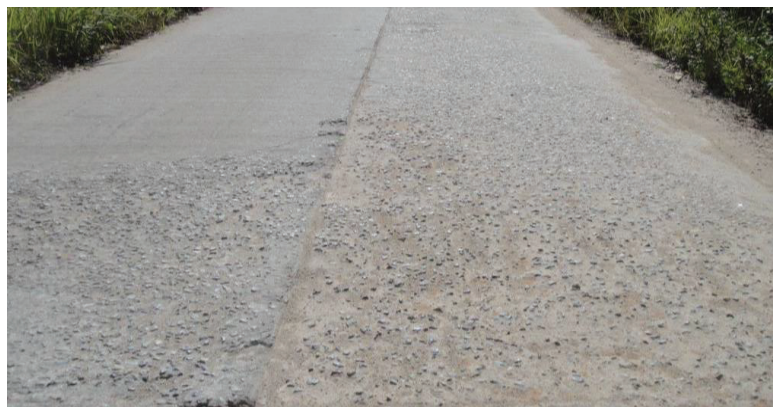
รูปที่ 3.26 ลักษณะความเสียหายของผิวทางคอนกรีต ประเภทหลุดร่อน
