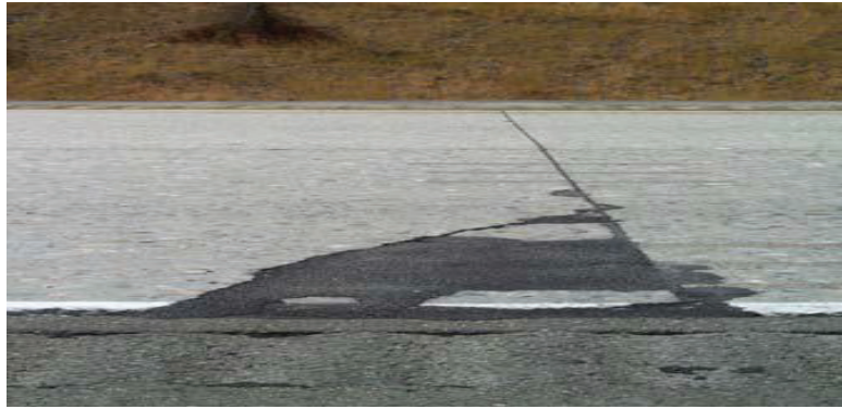
รูปที่ 3.21 ลักษณะความเสียหายของผิวทางคอนกรีต ประเภทรอยต่อหลุดร่อน
