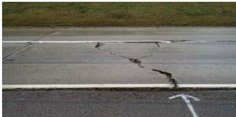
รูปที่ 3.18 ลักษณะความเสียหายของผิวทางคอนกรีต ประเภทแผ่นพื้นแตกและแยกตัว
