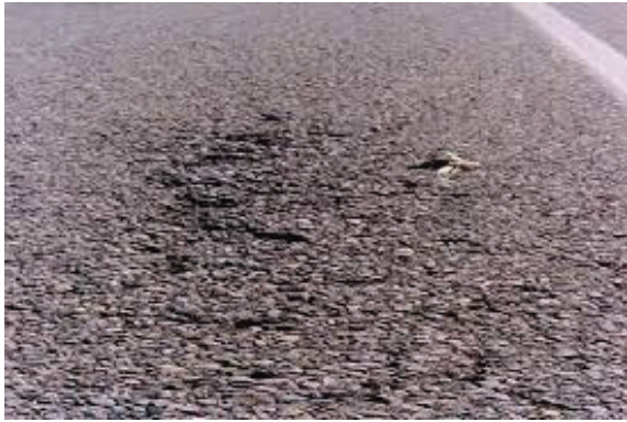
รูปที่ 1.3 ผิวทางหลุดร่อน (Raveling)
