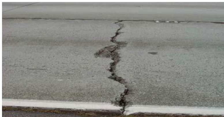
รูปที่ 3.28 ลักษณะความเสียหายของผิวทางคอนกรีต ประเภทแตกกะเทาะ
