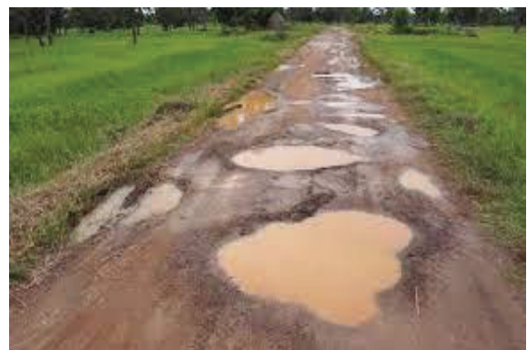
รูปที่ 1.2 หลุมบ่อบนถนนลูกรัง (Pothole)
