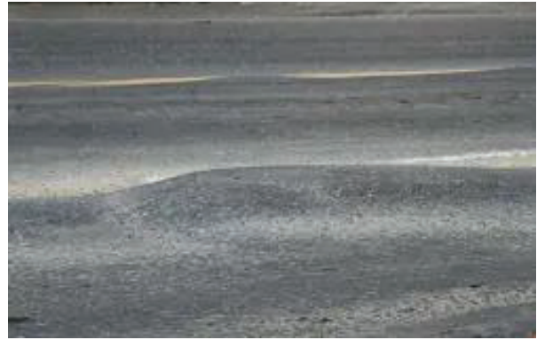
รูปที่ 1.4 ร่องล้อ (Rutting)
