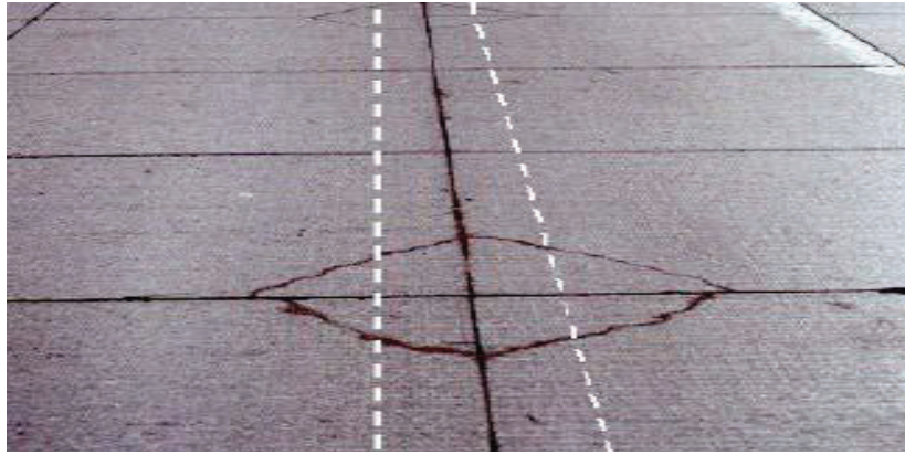
รูปที่ 3.17 ลักษณะความเสียหายของผิวทางคอนกรีต ประเภทรอยแตกตามมุม
